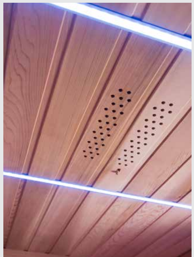
Air vent hatch in the ceiling. Entlüftungsschieber in der Decke.
